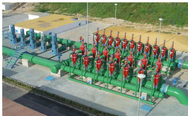
Figura 2.10. Estación de bombeo y filtrado de los sectores II y III.
