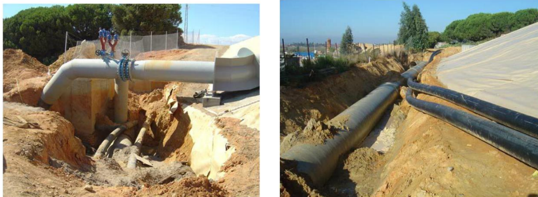
Figura 2.8. Tuberías del sector I.
