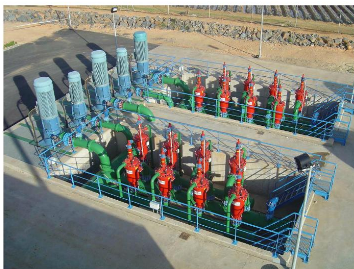
Figura 2.7. Sistema de bombeo y filtrado del sector I.
