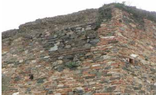
Figura 12: Detalle de fábrica de mampostería con alineamiento de ladrillos. Aparejo Toledano. LD/7-2.
