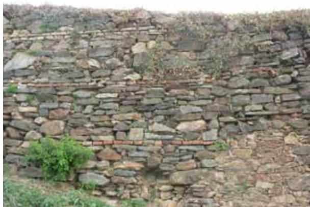
Figura 13: Fábrica de mampostería con alineamiento de ladrillos. Subtipo 7-4.
