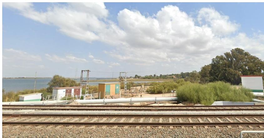
Figura 42 “Centro de transformación y medida”
