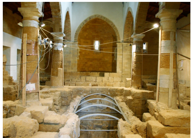
Figura 1. Chiesa di Santa Maria dei Greci durante i lavori di scavo dell’Aula liturgica.
