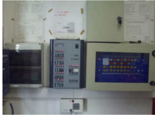
Cuadro eléctrico automático centralizado
