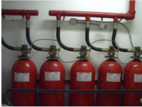
Sistema antiincendio automático centralizado
